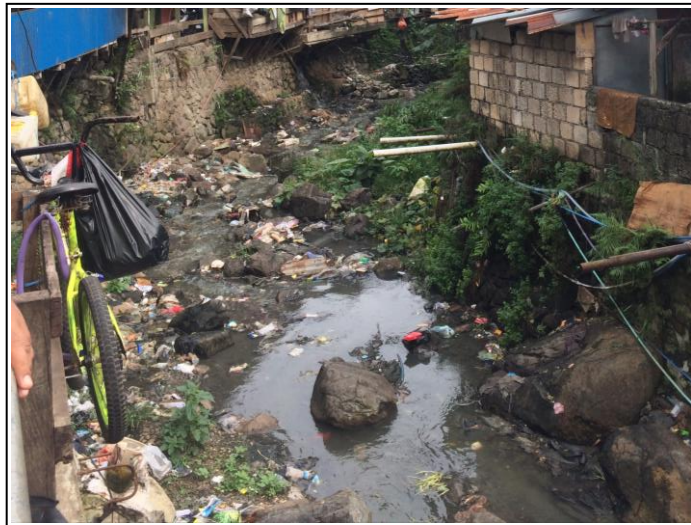
Gambar 9. Contoh Kondisi Saluran Pasangan Batu yang Rusak Sumber: Profil Kawasan Permukiman Kumuh, 2017
